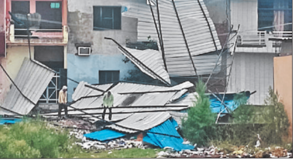
तरावड़ी। सत्संग भवन के लंगर हाल की टीन की छत गली के बीचों बीच पड़ी।
